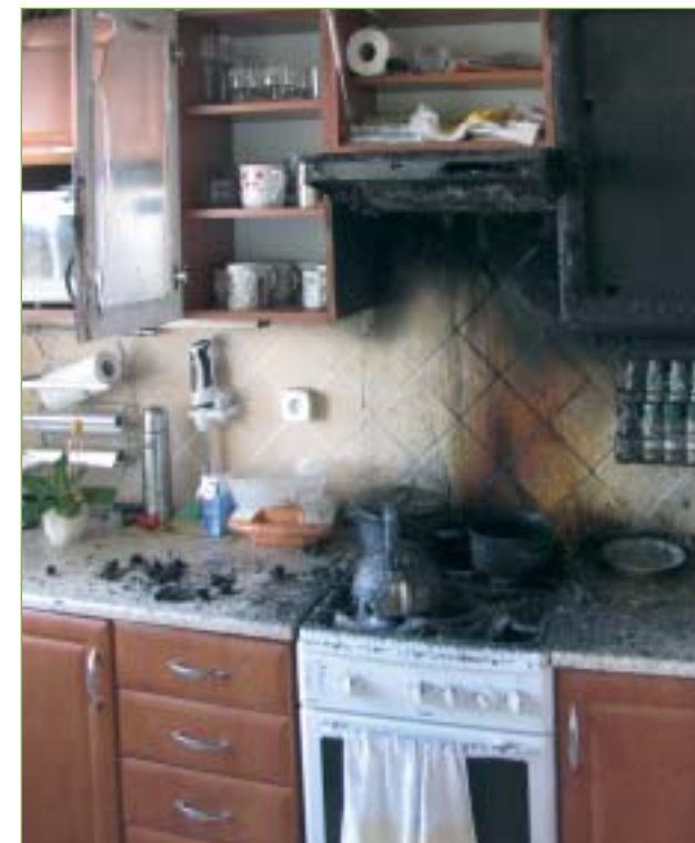
Kuchyně po požáru při vaření bez dozoru.
