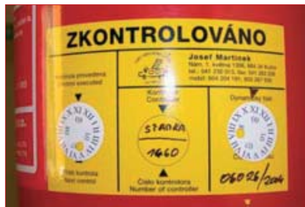
Příklad kontrolního štítku umístěného na PHP
